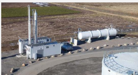
Figure 13 : Unité d'épuration du biogaz et réservoir de propane (ENEA Consulting, 2010)
